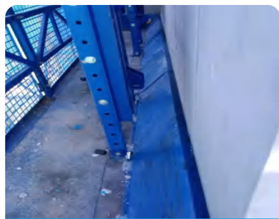
爬架翻板封闭
