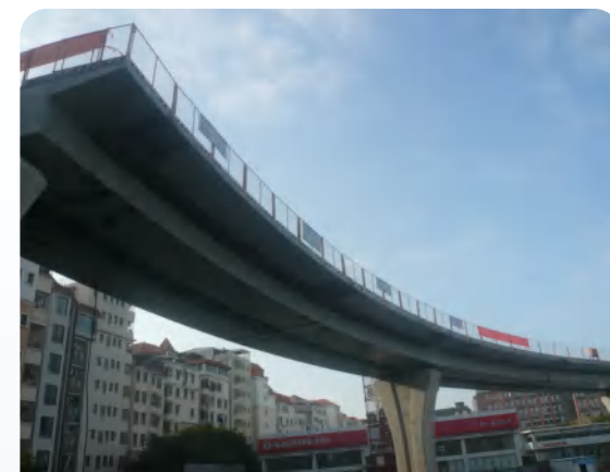
桥面临边防护
