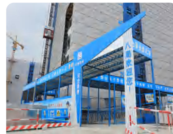
施工升降机防护棚
