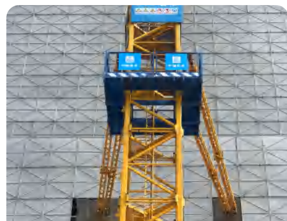
塔吊附墙及休息平台
