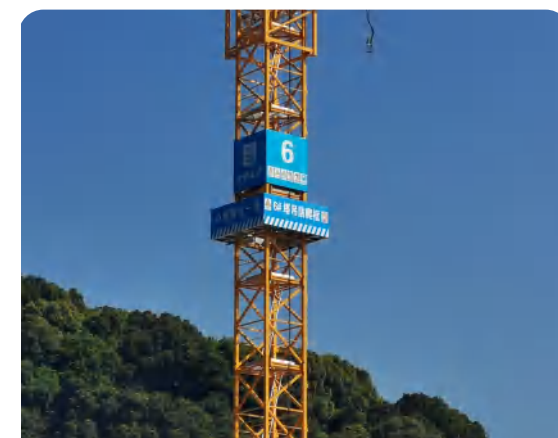
塔吊防攀爬框
