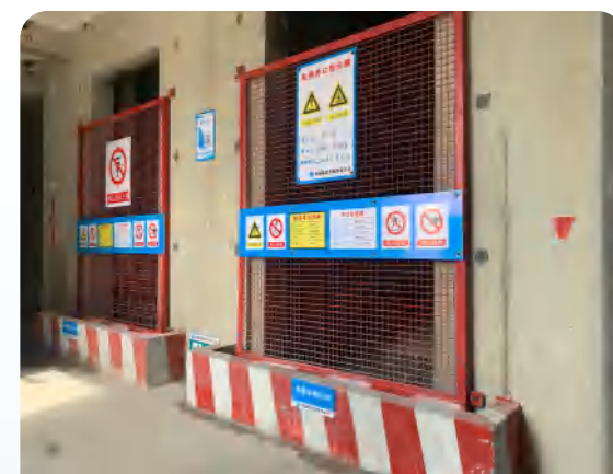
电梯井口防护
