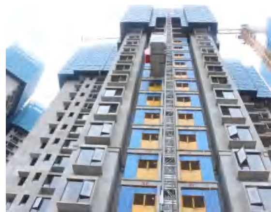
施工梯层门防护外观
