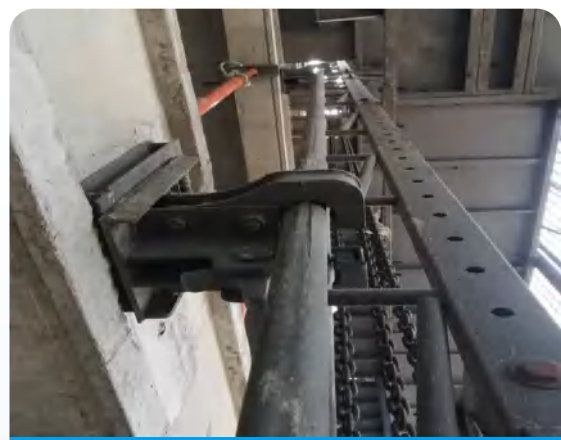
爬架导轨和附墙装置
