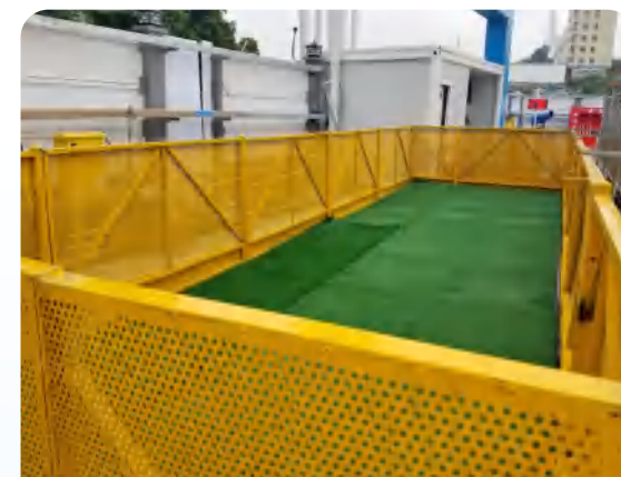
沉淀池污水处理
