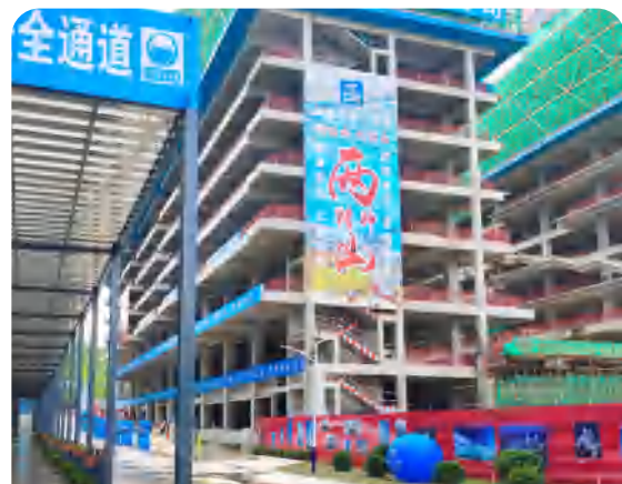
楼层临边防护
