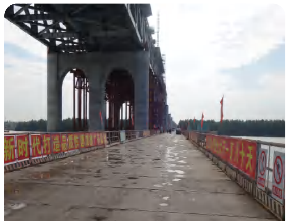
栈桥临边防护
