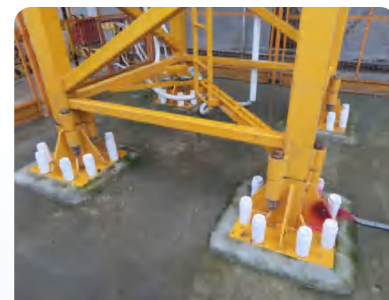
地脚螺栓防护
