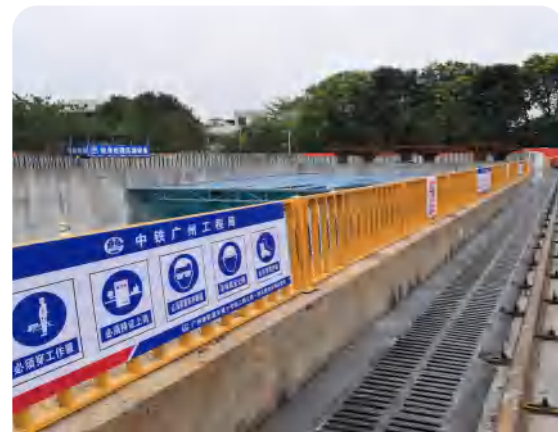
基坑临边防护
