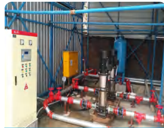
消防给水设施
