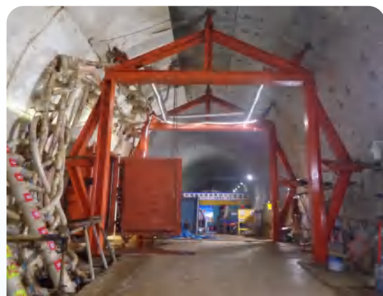
隧道内预应力支架
